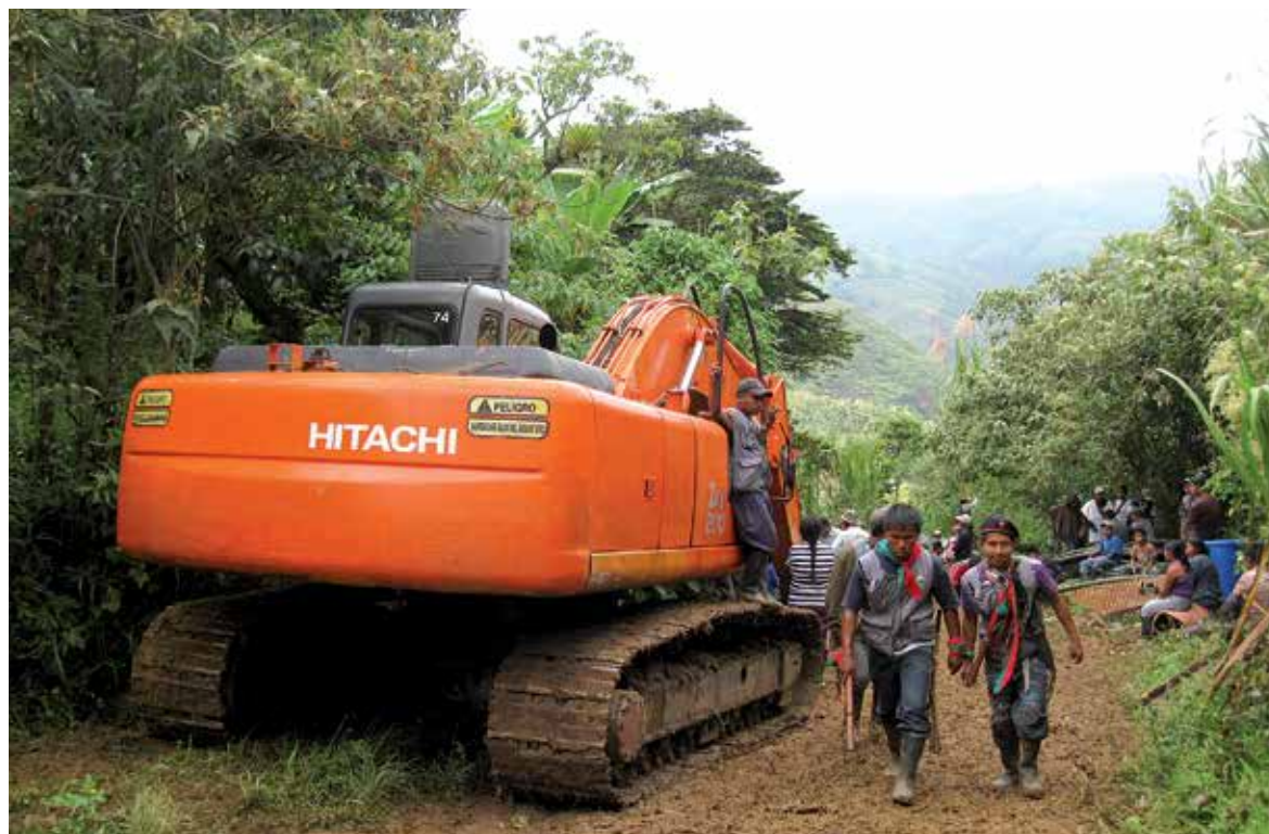
Las obras de infraestructura también generan un alto impacto ambiental.
